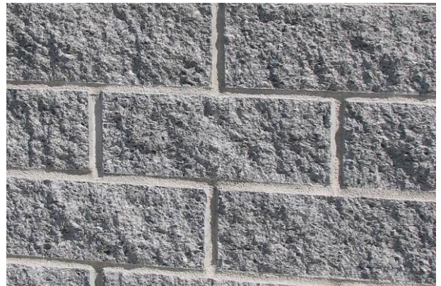
Bild 38: Läuferband mit Lager- und Stossfugen
