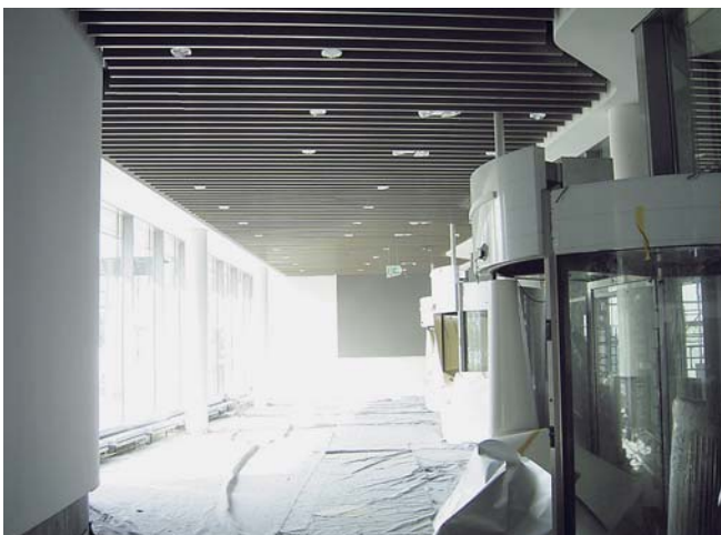
Unter den Deckelsegeln aus patiniertem Messing befindet sich die Kühldecke.
