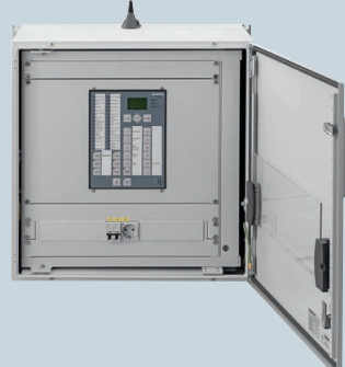
Steuerschrank mit Controller 7SC80
