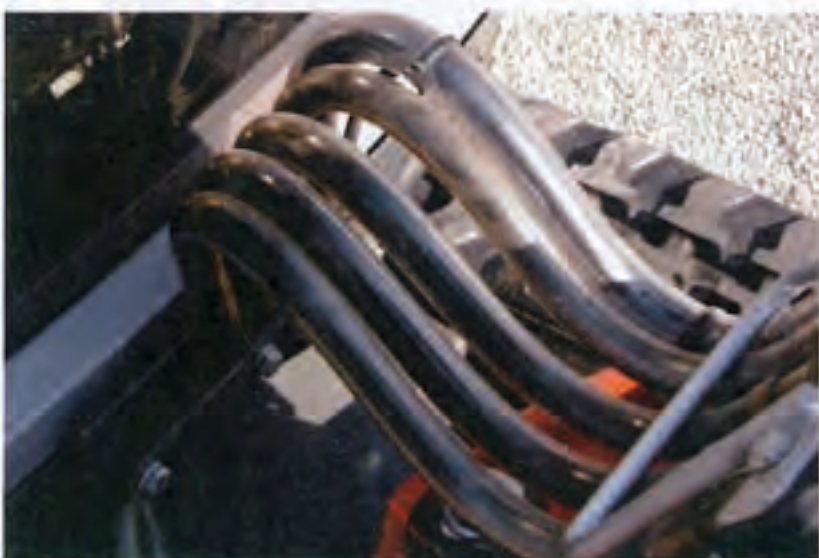
Bild 3: Außer der Festigkeit sind bei PVC-P-Schutzschläuchen auch die Weichmacher problematisch, insbesondere im Brandfall.
