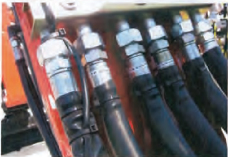
Bild 2: Schumpfschläuche sind als Leitungsschutz nicht zugelassen. Sie haben unter anderem nicht die notwendige Festigkeit.
