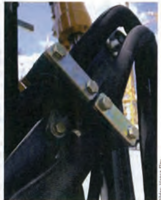
Bild 6: Werden Schutzschlauch, Druckleitung und Schlauchschelle gemeinsam verlegt, geht die Schutzwirkung verloren. Eine getrennte Verlegung ist zwingend notwendig.
