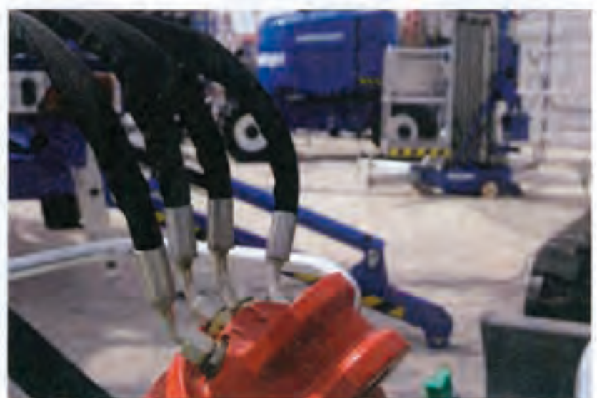
Bild 4: Das gemeinsame Einbinden ist nicht zulässig. Diese Schlauchleitung ist nicht prozesssicher.
