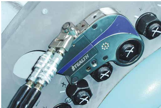
↑ Flach und schnell: Einsatz an einer Windkraftanlagen
