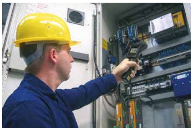
Detaillierte Infrarottemperaturmessung an einer elektrischen Steuerung mit Hilfe der eingebauten Scharfpointoptik des Dual Focus im 1 Millimeterbereich
