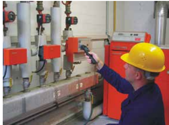
Überprüfen der Temperatur an Heizkreisen
