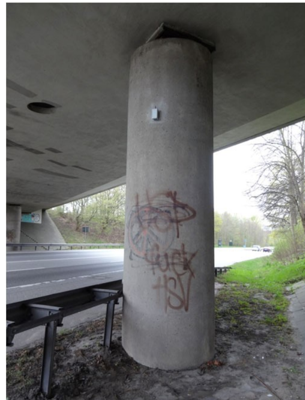
Bild 157: Anbringung des Neigungssensors an der Fahrbahnüberquerung in Segeberg
