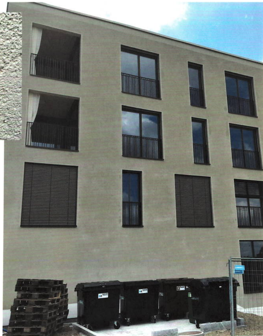
7 Störend sichtbare Glattstellen in der Kratzputzstruktur.
