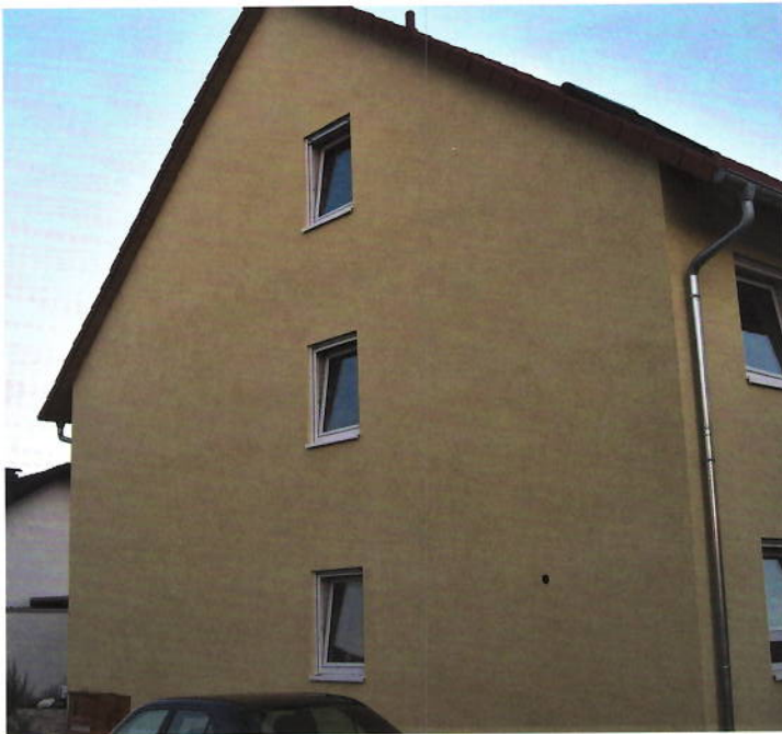
8 Gerüstlagenabzeichnung, verursacht in der Putzstruktur. Die störende Sichtbarkeit ist gegeben, eine Behebung erfolgt mit erneut aufgetragenen Putzlagen.
