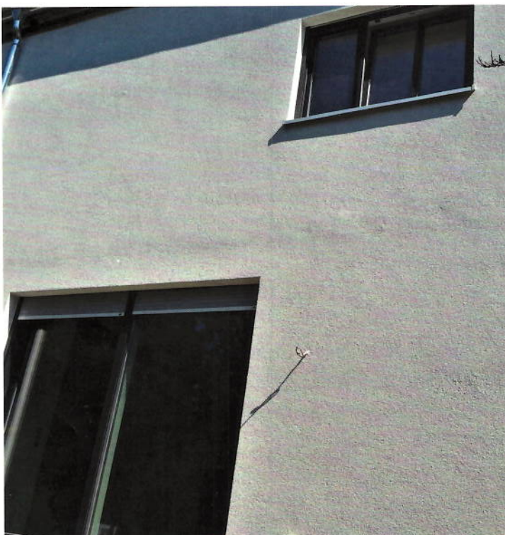
9 Ungleichmäßigkeit in der Putzstruktur, welche auch ohne Streiflicht erkennbar ist.
