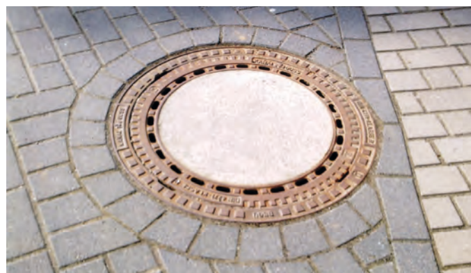
Bild 12: Fachlich und handwerklich weitgehend gelungener Anschluss einer Pflasterdecke aus Rechtecksteinen an einen Schachtdeckel mithilfe von Passsteinen Foto: SLG
