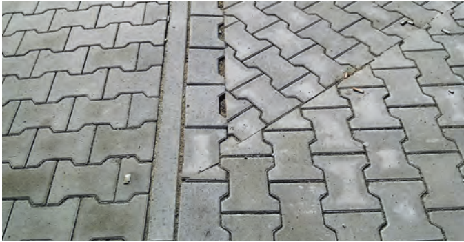
Bild 13: Für derartige Anschlussbereiche können die handwerklichen Regeln keine fachlich befriedigende Lösung anbieten, sie sind individuell und einvernehmlich zu gestalten Foto: SLG
