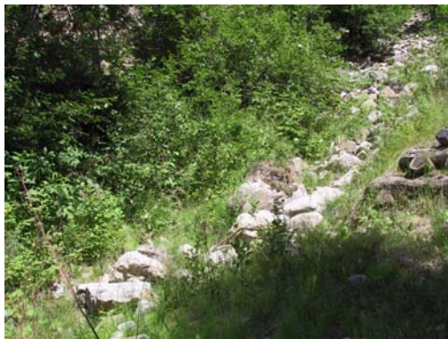
Abb. 57: Kronengraben - offene Anrisse oberhalb des Forstweges (Sommer 2003)
