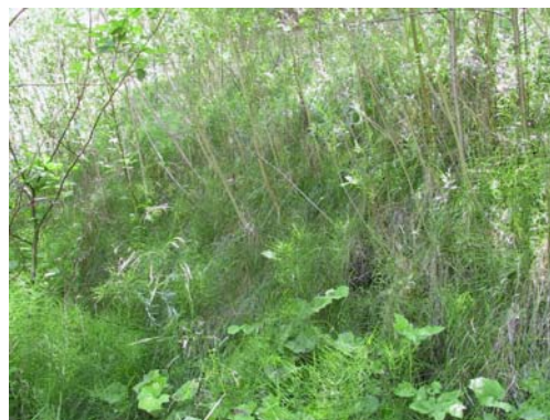
Abb. 187: Kronengraben Krainerwand 02 – eine dichte Krautschicht verdeckt den Holzkasten vollständig
