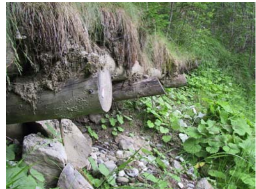
Abb. 76: Finsterbach Krainerwand 03.1 - durch Hangsetzung lösten sich die unteren Rundhölzer
