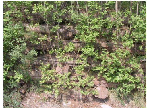
Abb. 62: Widmayer Krainerwand 03 – umfangreiche Vermorschungserscheinungen am Holz
