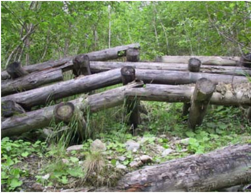
Abb. 84: Bruchstelle des Krainerwandkastens 03.1 - Finsterbach
