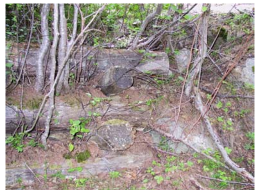
Abb. 118: schlechte Hangeinbindung Holzerlahn Krainerwand 04
