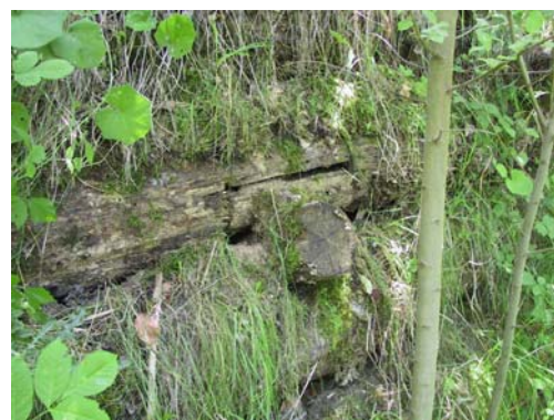
Abb. 6: Tscheiner Krainerwand 01 – schlechte Überlappung
