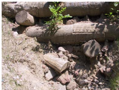
Abb. 180: Beispiel für schlechte Einbindung am Krainerwandfuß und gute Überlappung – Standort Oberpremer Krainerwand 02
