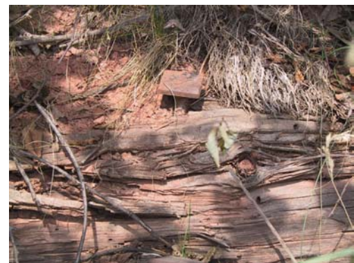
Abb. 64: Widmayer - schlechter Holzzustand bei vielen Reihe
