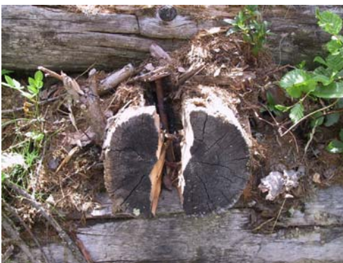
Abb. 117: Holzerlahn Krainerwand 03 durch Bauarbeiten in Mitleidenschaft gezogen
