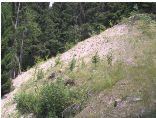
Abb. 30: Vegetationsloser Hanganriss oberhalb der Krainerwandsicherung – Oberpremer (Sommer 2003)
