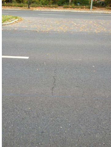
Zustand 0: Beginnende Querrissbildung
