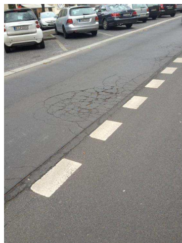
Zustand 4: Materialausbrüche und Schlaglochbildung
