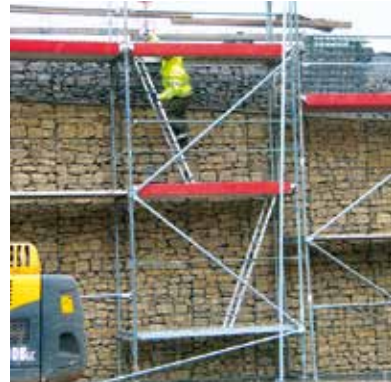
Dreiteiliger Seitenschutz in Arbeitsfeldern des Gerüstes! Sicherer Aufstieg mittels Leitengang bis 5 m Höhe.
