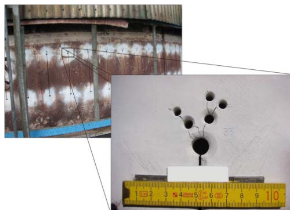
Abbildung 44: Wiederholte Rissbildung am Ende eines mit Abschlussbohrung versehenen Schlitzes in einer Behälterwand.
