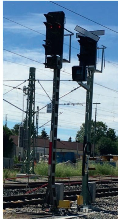
Abb. 2: LST ohne EULYNX- Standardschnittstellen führt zu schweren wirtschaftlichen Nachteilen, da ein Ersatz der Stellwerksinnenanlage stets den Ersatz werthaltiger Außenanlagen erfordert. Beispiel: Bahnhof Aulendorf, 5. Juli 2020
