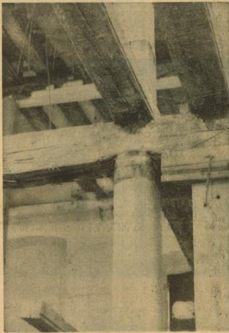
So sah es im Zeughausmuseum bei Beginn des Umbaus aus. Wie notwendig der Umbau war, beweist allein schon dieses Bild, das erkennen läßt, wie sehr sich der hölzerne Stützpfiler in den Oberbalken gedrückt hat. Die Absenkungen der Decke betragen bis zu 28 Zentimeter! Hervorgezogen wurden die Absenkungen durch eine Ueberbelastung in Verbindung mit dem Vermodern der verwendeten Holzträger.
