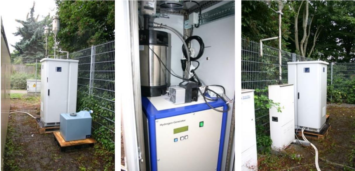
Abbildung 6.6: Außenaufstellung des Elektrolyseurs neben dem Messcontainer
