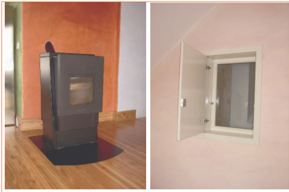
Abbildung 4-43: links: Raumpellet-Ofen EG, rechts: Zugang Pelletlager OG
