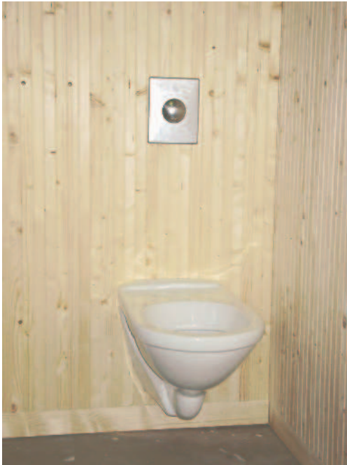
Keramik-Toilette mit Spülkastenbetätigung über Druckluft
