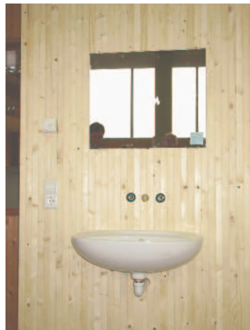
Sichtbare Brettstapel-Wand mit Elektro-Verteilung (Raumthermostat, Schalter, Dose), Wasserverteiler hinter Spiegel, Anschlüsse für Aufputzwandarmatur und Waschbecken
