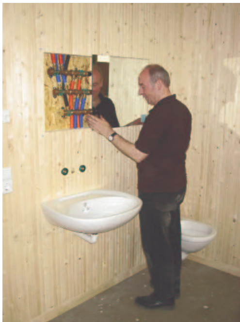
Die Wasserverteiler (Kalt-, Warm- und Betriebswasser) sind hinter einem abnehmbaren Spiegel installiert
