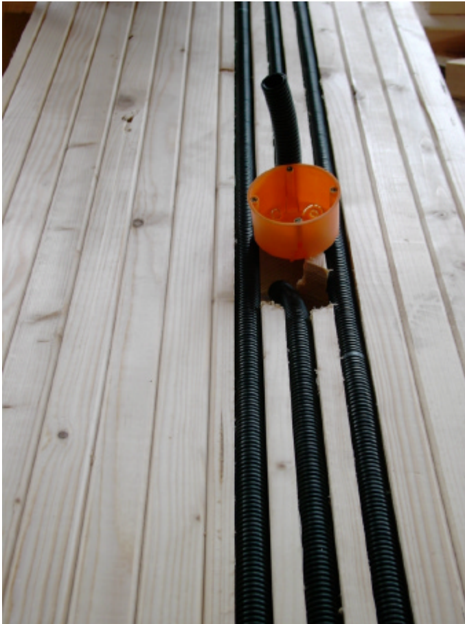
Abbildung 5-18: Brettstapel mit Elektroinstallation
