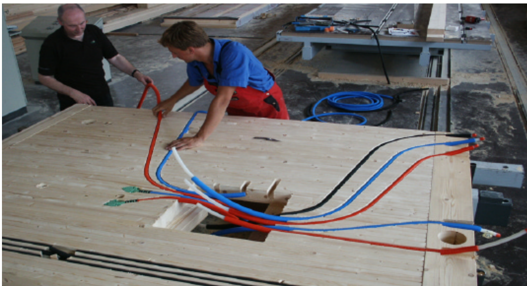
Abb 3. in Basys realisiertes Musterbauteil als Beispiel für eine bauteilintegrierte Installation; Der Verteiler befindet sich in einer Aussparung oberhalb des Waschbeckens, die durch den Spiegel verdeckt wird; im Bild mittig. (Quelle: ifib)
