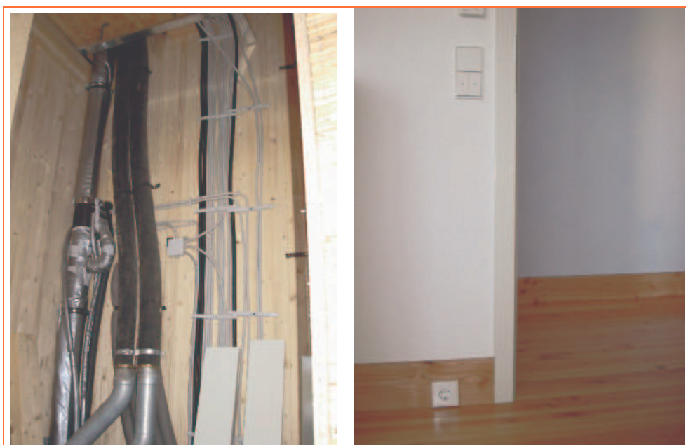
Abbildung 4-46: links: Installationswand, rechts Sockelkanal mit Elektrodose
