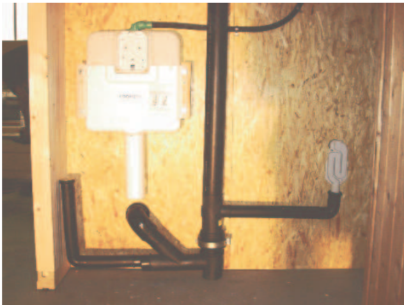
Rückseitig zugängliche Installationswand (unterer Bereich) mit wassersparendem WC-Kasten, Abwassersystem und Siphon
