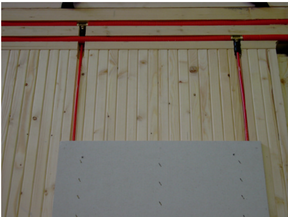
Abbildung 6-15: Heizleitungen im Rähm, Wandheizfläche
