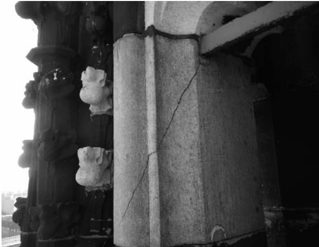
Riss in Filialturm Nordost
