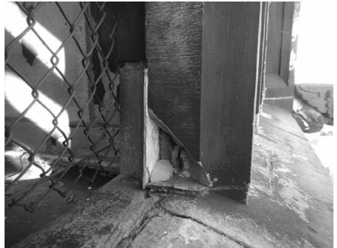
Durch rostenden Dorn abgedrücktes Mittelgewändestück
