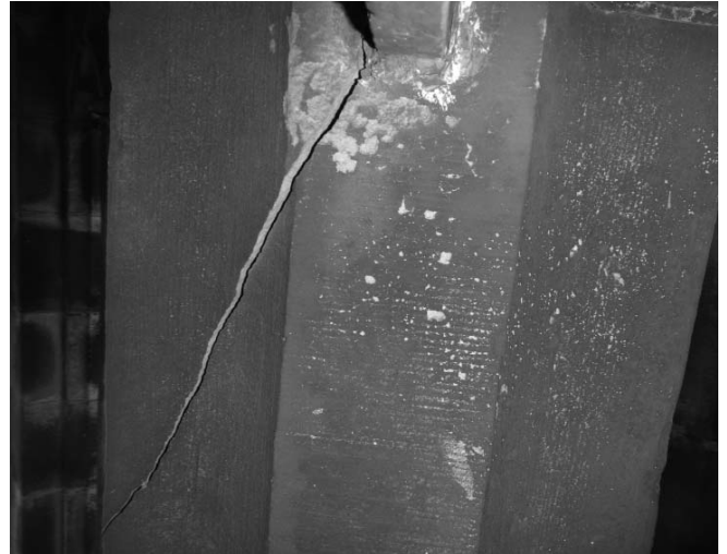
Riss durch Mittelgewände zur Innenseite des Oktagons
