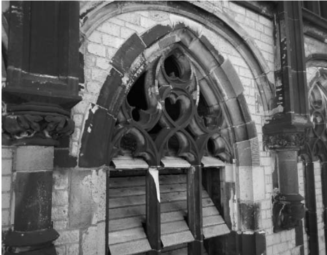
Unterhalb des Windeisens/Zugankers herausgebrochenes Mittelgewändestück
