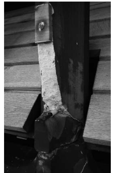
Rostende Verdübelung, herausgebrochene Vierung
