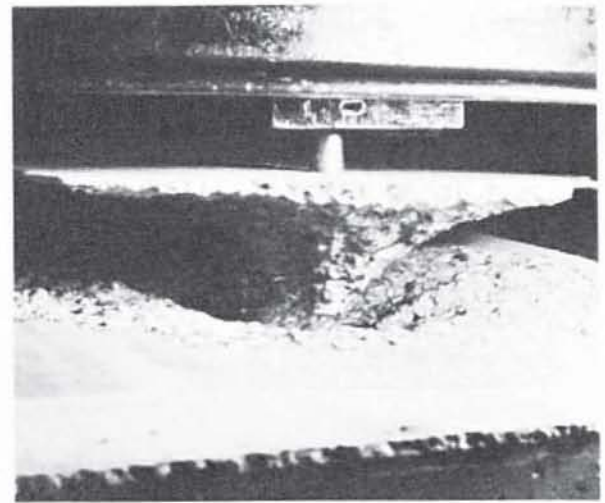
Bild 8 Bruchbild bei Betonausbruch
