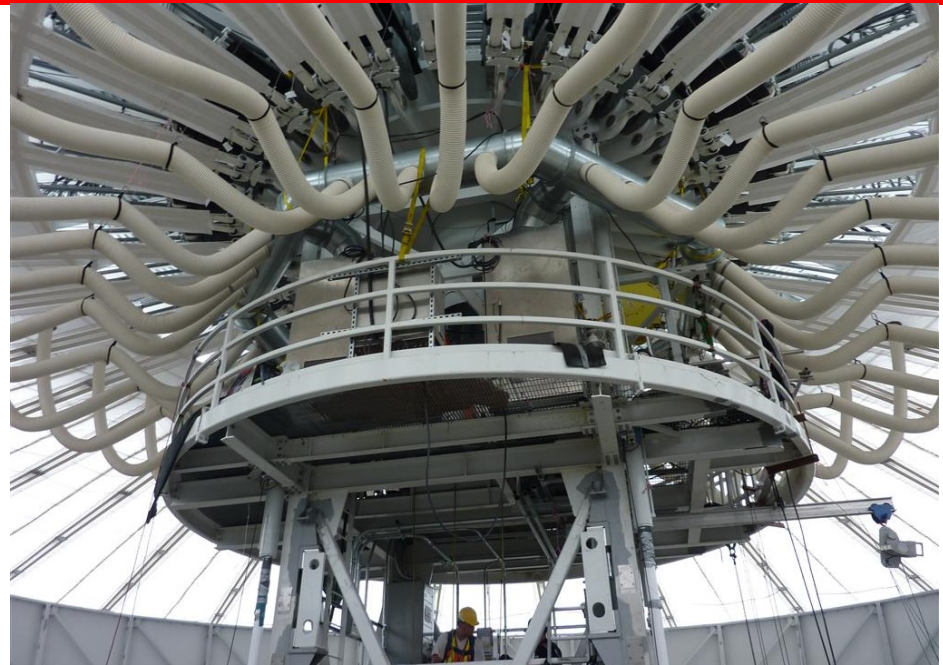
BC Place Stadion, Vancouver, Kanada, Stützluftversorgung der elnic GmbH
