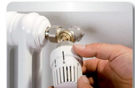
Prüfen der Voreinstellung an einem Thermostatventil
