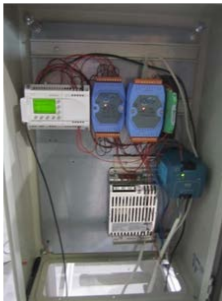
Abbildung 2.24: Steuerung und Messwerterfassung
