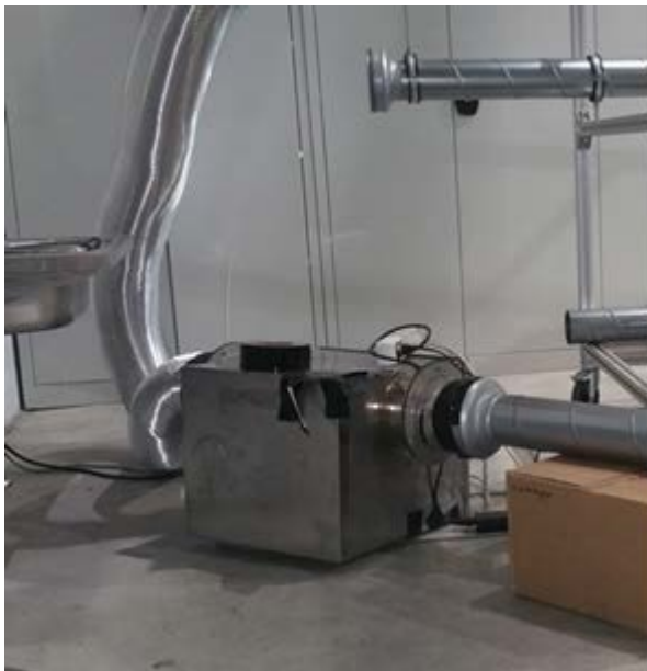
Abbildung 2.23: Lüfter am Messaufbau
