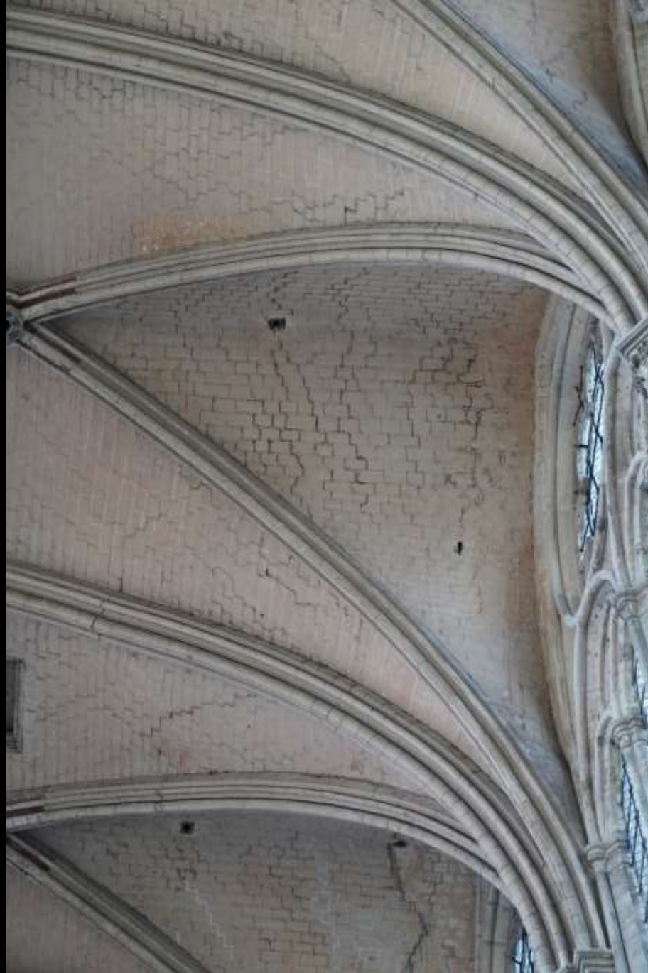
Sabouret-Risse in den Schildkappen eines Kreuzrippengewölbes (Kathedrale Amiens, 13. Jh.)
