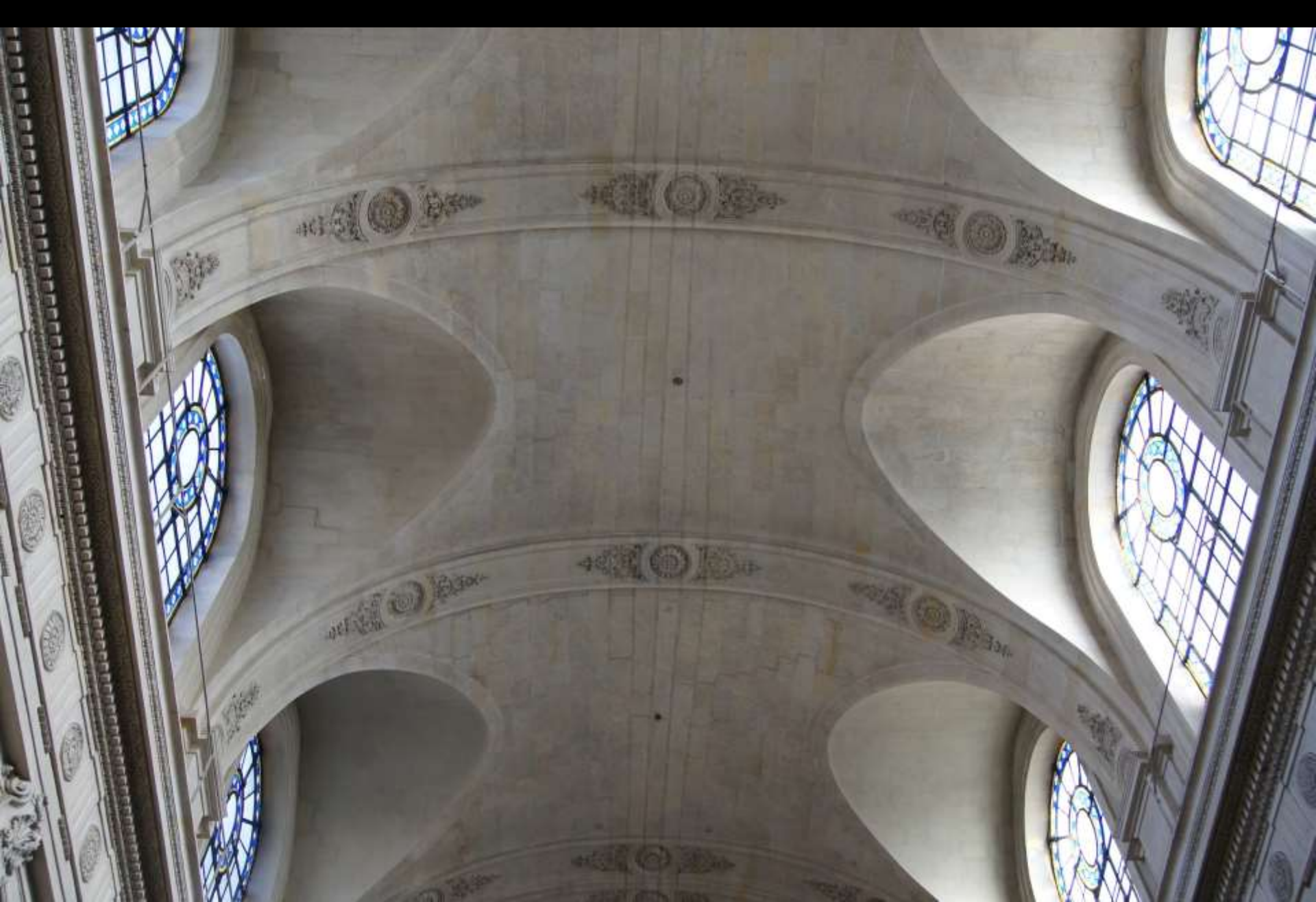
Scheitelrisse in einer Stichkappentonne (Paris, Saint Roch, 17. Jh.)
