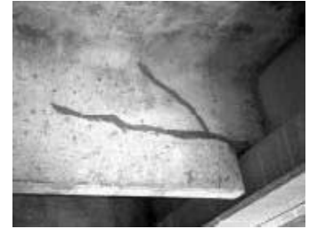
► Aparcamiento (Pittsburg, USA) © Nanni, 1999
