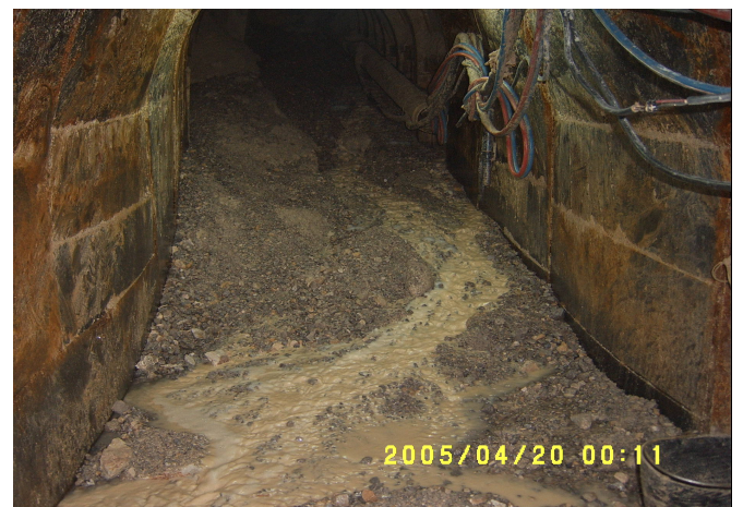
Bild 3: Grösstenteils verfüllter Bypass 4
