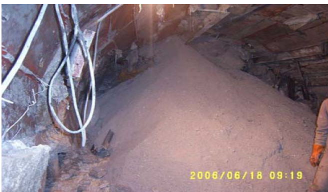
Bild 6: Verbruch (Kollaps) Tm 7600
