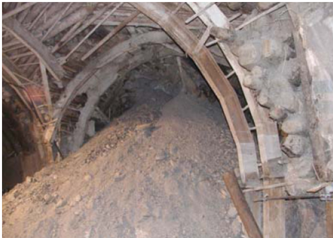
Bild 7: Verbruch bei der Einmündung Adit 4 in den Haupttunnel
