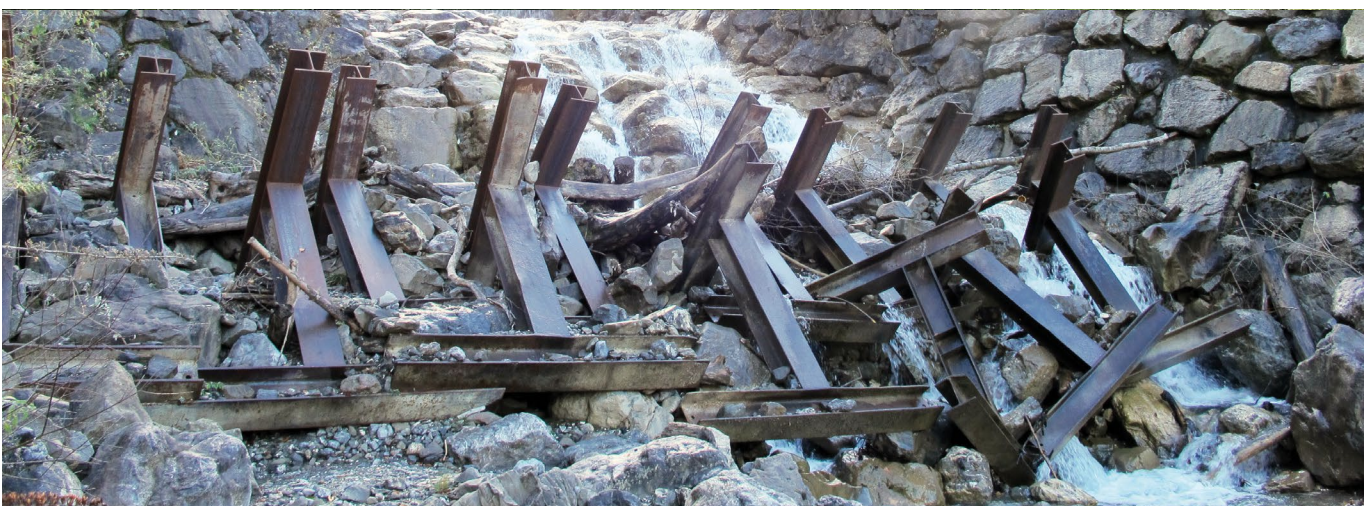
Alterndes Schwemmholzrückhaltesystem aus verschweissten H-Profilen im Gruonbach (UR), 2014. Foto: Martin Frei.
