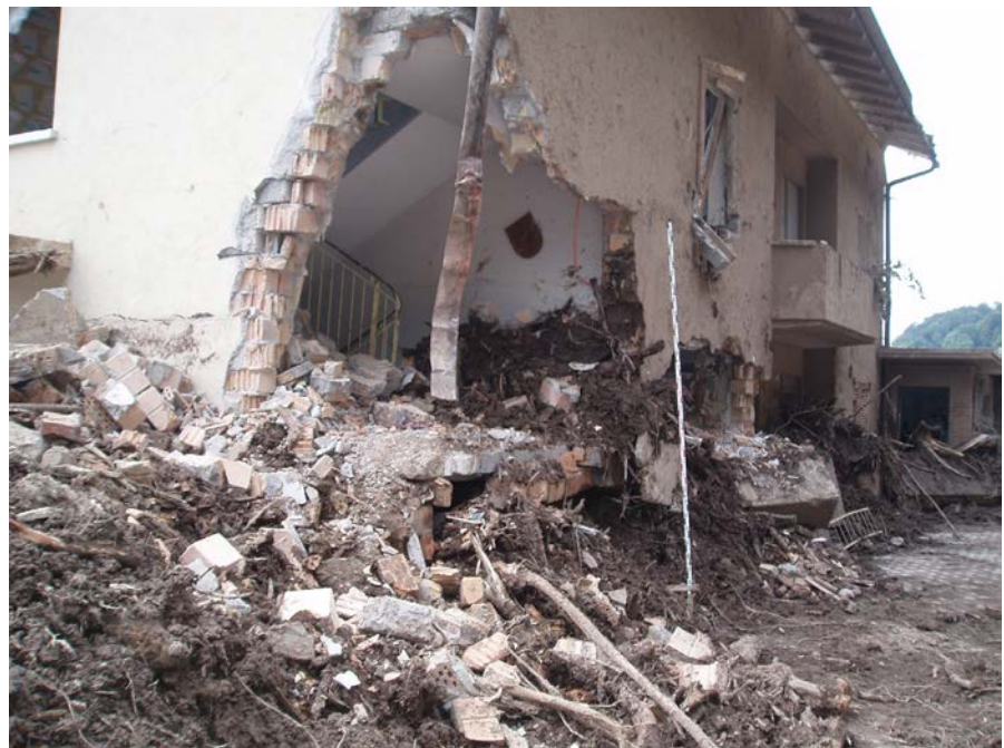
Abbildung 2: Beschädigung der Tragkonstruktion eines Gebäudes in Gersau 2005 (Foto: Egli Engineering AG)
