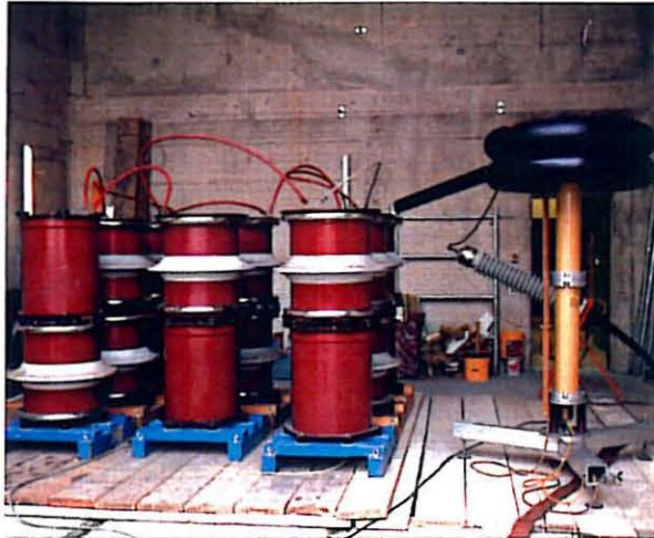
Figur 8: Vor-Ort-Wechselspannungsprüfung einer 132-kV Kabelanlage mit EPR-Isolation.
