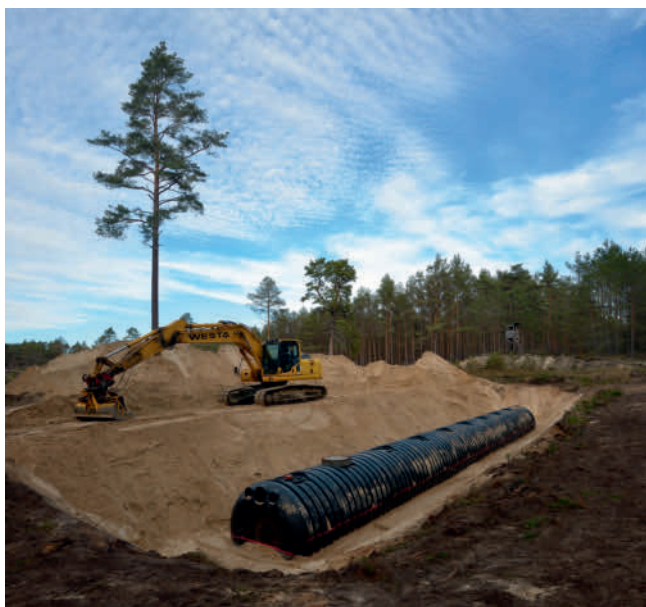
Abb. 3: Unterirdischer Löschwasserbehälter Modellregion Forstamt Kaliß (Foto: THOR 2022)
