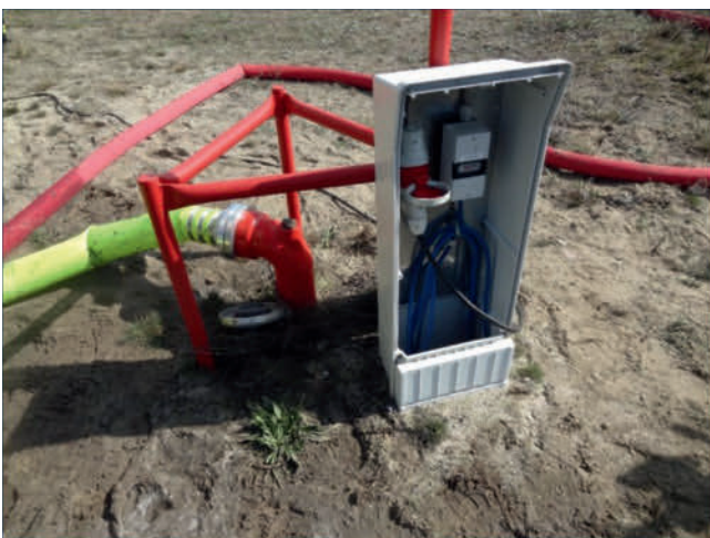
Abb. 14: Künstliche Löschwasserversorgung – Tiefbrunnen auf dem ehemaligen Truppenübungsplatz Jüterbog
