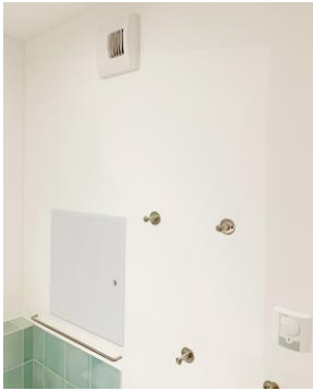
Abb. 4: Entlüftungssystem eines fensterlosen Bades oder Bauteil einer Lüftungsanlage für die gesamte Wohnung? Von der Antwort hängt ab, welche Maßnahmen Blower-Door-Messteams für eine GEG-Schlussmessung ergreifen müssen. © Foto: FLiB
