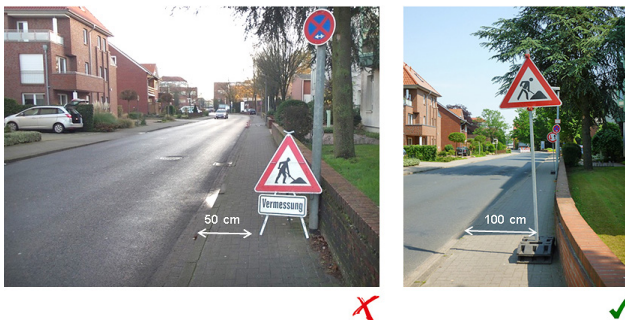
Abb. 3: Mindestbreiten am Gehweg (1,0 m) sind häufig nur mit hohen Verkehrszeichen am Vierkantrohr einzuhalten.
