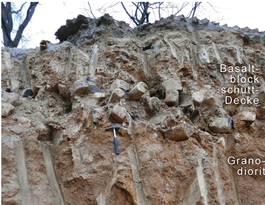
Abb. 11: Basaltblockschuttdecke über Zweiglimmergranodiorit. Baugrube der neuen Schulsporthalle Stolpen, Pirnaer Landstrasse 1. 330 m westlich der Burg (Foto: T. Scholle, 24.3.2015)
