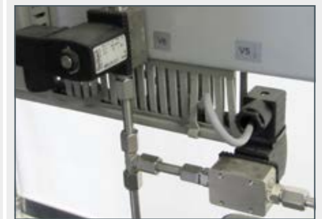
Magnetventile im Heizwasserkreislauf
