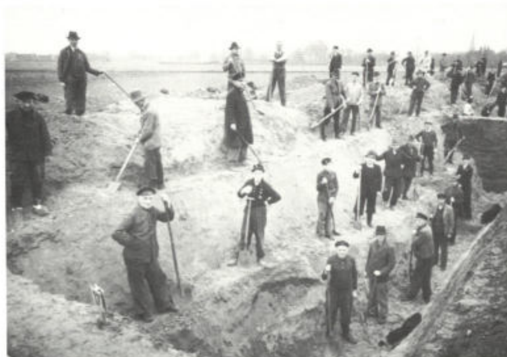
Abb. 6. Ein numerierter Grabenabschnitt; deutlich zu erkennen ist das Hilfsbankett an der Innenseite des Grabens; im Hintergrund der Turm von St. Clemens in Fischeln
