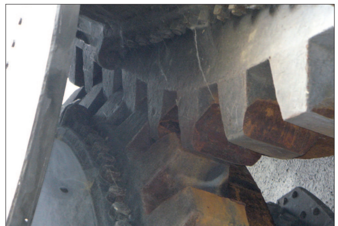
Bild 7: Plastische Verformungen der Zahnschiene und der Zahnkränze an der Versenkwalze der Mainstaustufe Viereth (Braun, 2009 und 2011)
