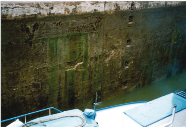
Bild 3: Zustand der Kammerwand vor der Instandsetzung
