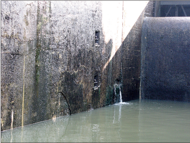
Bild 20: Wasserdurchtritt infolge rückseitiger Durchfeuchtung
