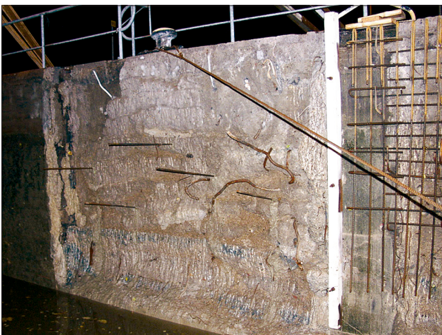
Bild 23: Bewehrungseisen im Altbeton
