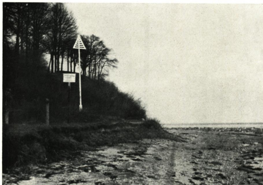
Abb. 24. Abbruchkante am südlichen Ende des „Söhrmandammes“, 16. Januar 1950
