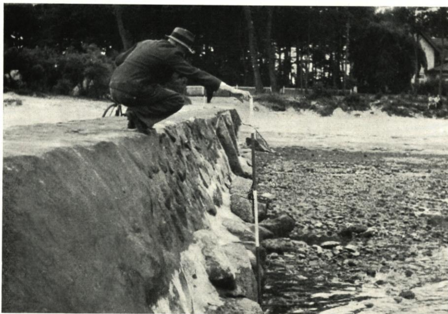
Abb. 35. Timmendorfer Strand, Abbruch an der Leeseite einer Findlingsbuhne am 11. Juli 1950 bei -20\text{cm MW}
