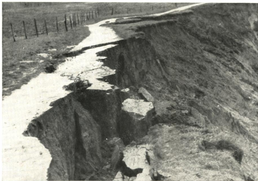
Abb. 7. Brodtener Ufer, 16. Januar 1950. Staffelförmiger Schollenabbruch an der Koppel Ahrenlande als Folge von Grundwasseraustritt und Frostwirkung
