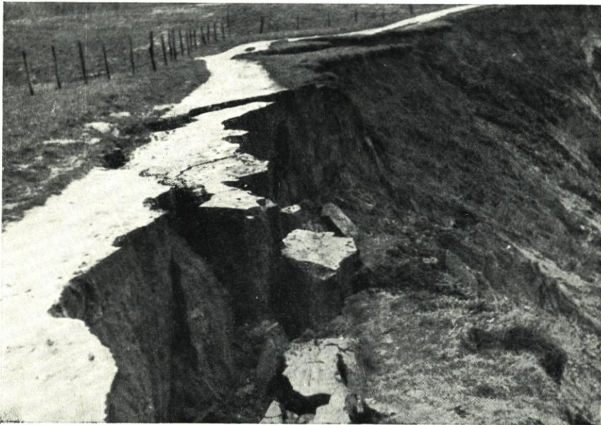
Abb. 7. Staffelförmiger Schollenabbruch als Folge von Grundwasseraustritt und Frostwirkung Fig. 7. Stepped erosion of blocks of material as a result ground water discharge and frost action.
