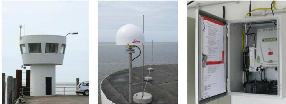
Abb. 2-25: Pegelhaus mit GNSS-Station des Pegels Dagebüll (links) und Schaltschrank im Pegelhaus (rechts)
