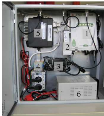
Abb. 2-18: Schaltschrank mit Leica GRX1200+ GNSS (1), GFU24 (2), Netzteil (3), Timer (4), Hermes Microcom Datenfunkgerät (5), Stromversorgung Datenfunkgerät (6)
