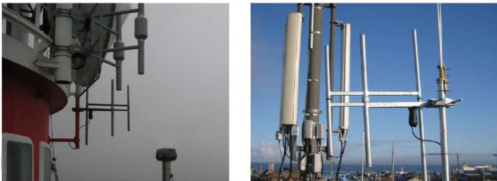
Abb. 2-19: Yagi-Antennen der Richtfunkstrecke LHAW(links) - Cuxhaven (rechts)
