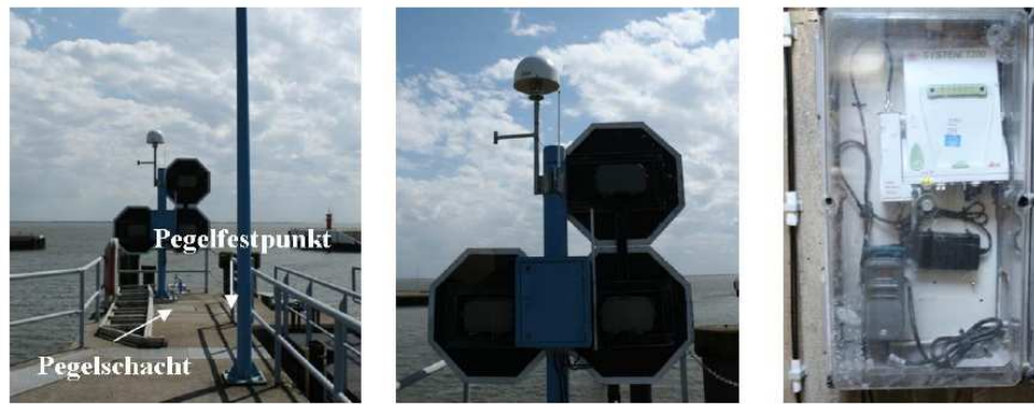
Abb. 2-23: Signalmast mit installierter Antenne und Schaltschrank im Pegelschacht der Station Buisum
