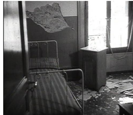
Abbildung 17: Schäden in einem Gebäude in Sierre nach dem Erdbeben vom 25. Januar 1946
