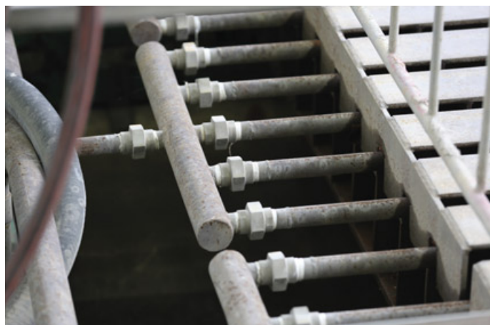
Abbildung 18: Anschlüsse der Reifenwaschanlage (Aufnahmedatum: 4. Februar 2021)
