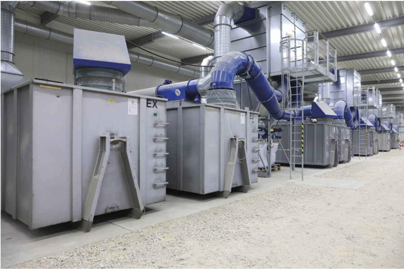
Abbildung 43: Aktivkohlefilter der Abluftreinigungsanlage (Aufnahmedatum: 9. November 2020)
