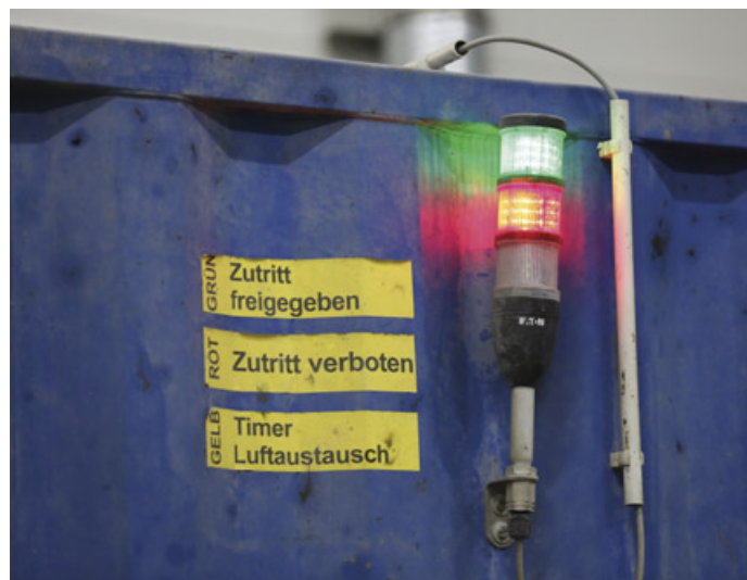
Abbildung 55: Zutrittssteuerung zur Containerschleuse per Ampel (Aufnahmedatum: 4. Februar 2021)
