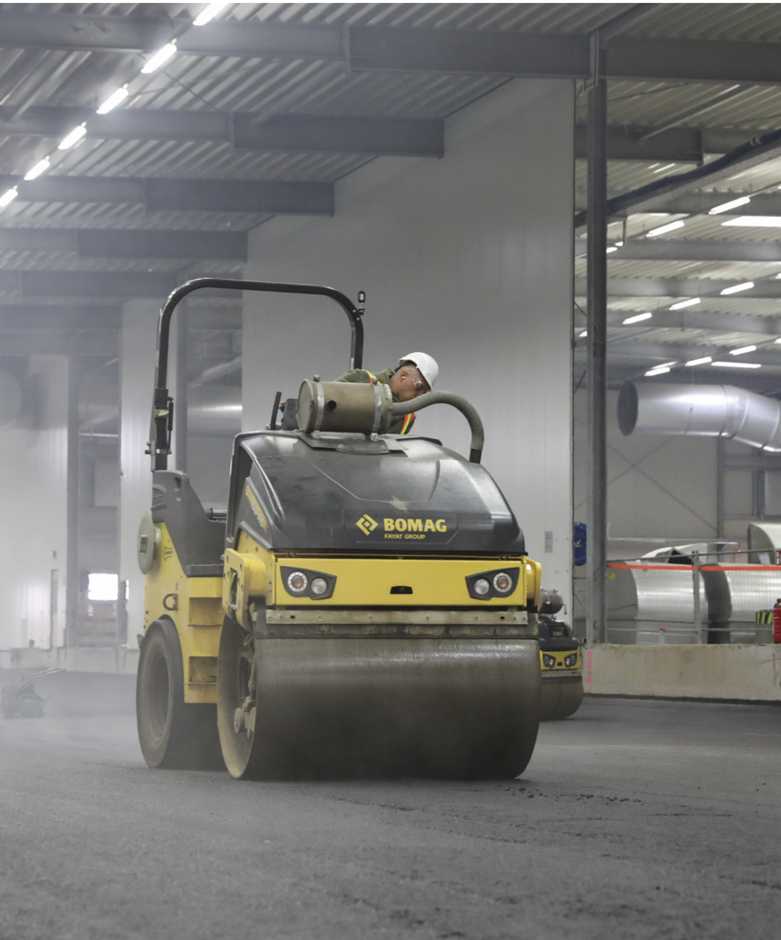
Abbildung 61: Mit einer Walze wird die Asphaltdecke auf dem bereits sanierten Baufeld Süd verdichtet (Aufnahmedatum: 11. Mai 2020)
