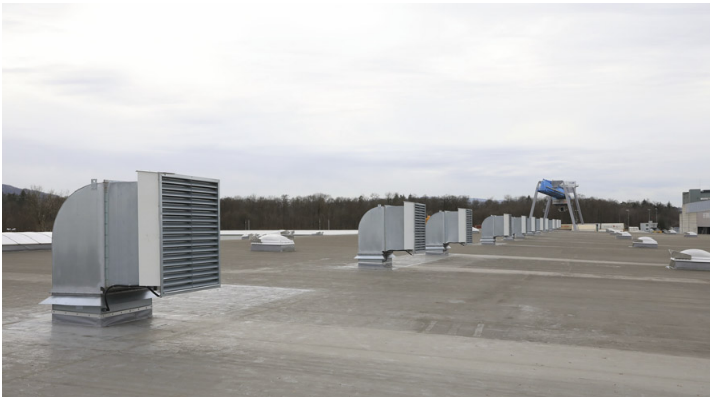
Abbildung 15: Entlüftungsrohre mit Luftfiltern auf dem Dach der Sanierungshalle (Aufnahmedatum: 4. Februar 2021)
