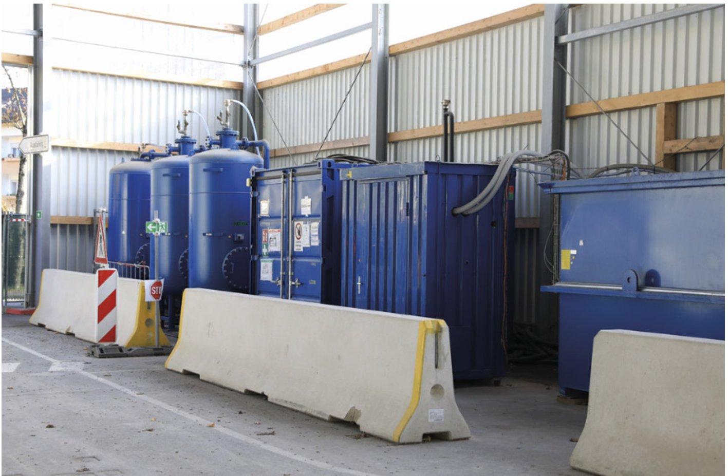
Abbildung 26: Die Abwasserreinigungsanlage auf der Logistikfläche des Perimeters 3. Das gereinigte Wasser wird als Brauchwasser wiederverwendet (Aufnahmedatum: 9. November 2020)
