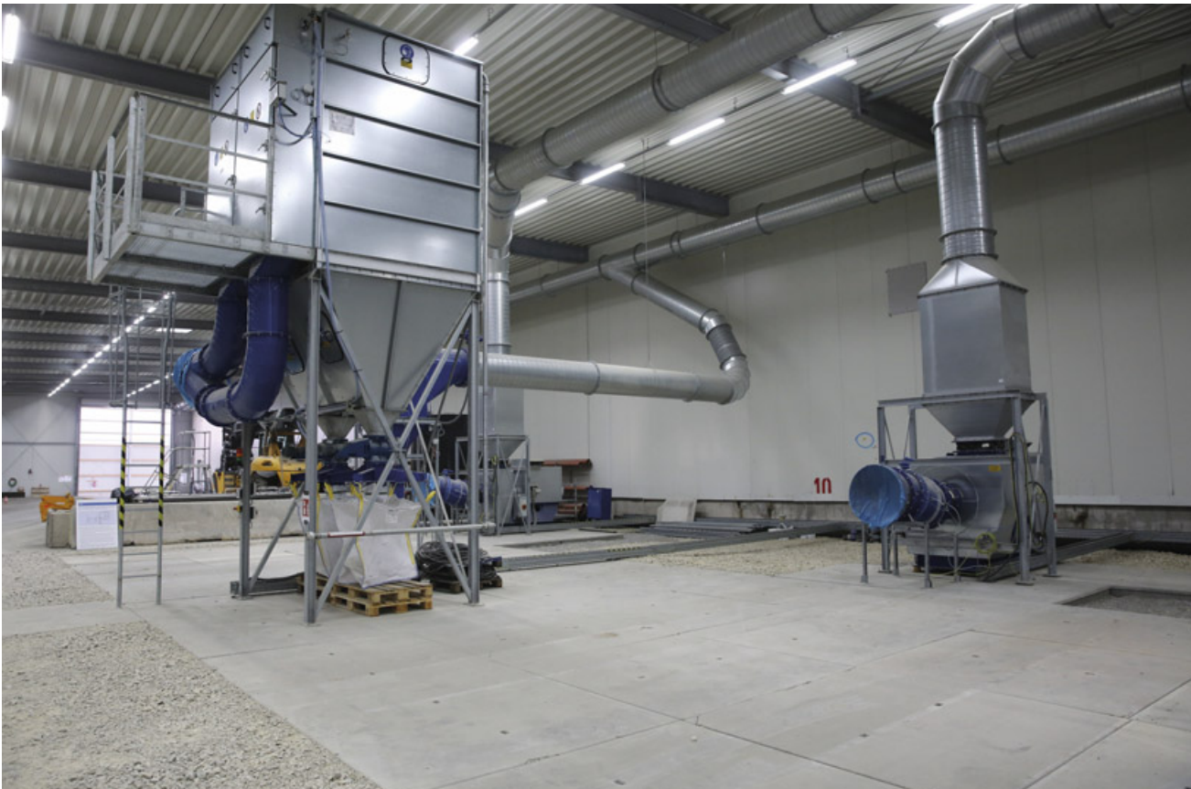
Abbildung 44: Abluftreinigungsanlage wartet auf neuen Aktivkohlefilter (Aufnahmedatum: 8. Dezember 2020)
