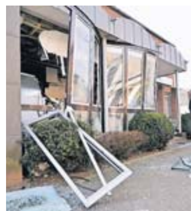
Der Vorbau ist völlig zerstört.
