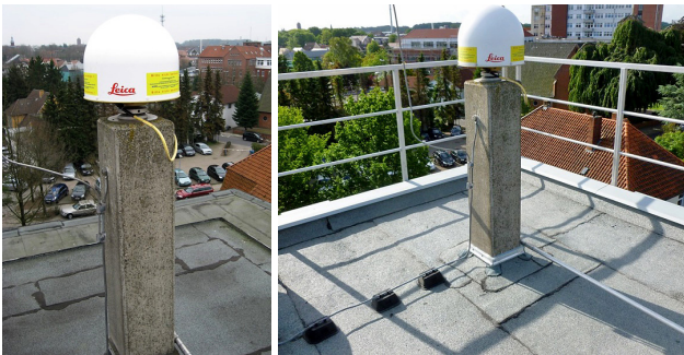
Abb. 6: SAPOS-Station Cloppenburg mit und ohne Absturz- sicherung
