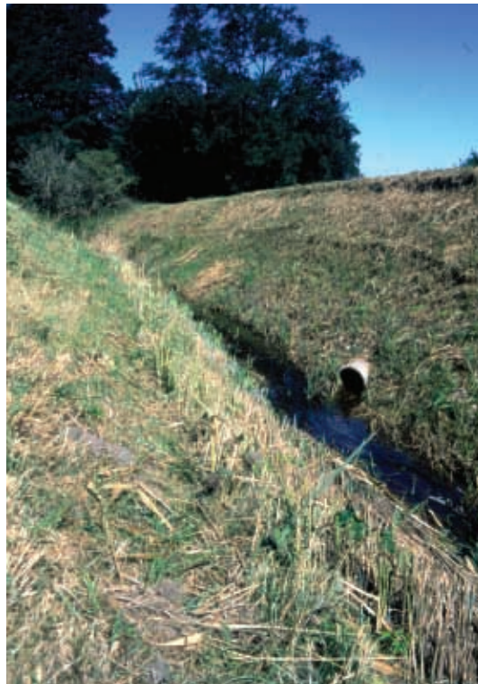
Bild 2.57: Niedrige Einlässe von Dränen verhindern den Rückbau der starken Eintiefung der Gräben im Oberlauf (H. LENGSELD 2002)
