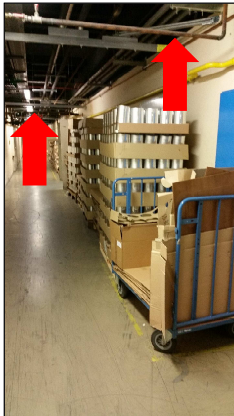
Anlage 12 Versorgungsleitungen Gangbereich GKL
