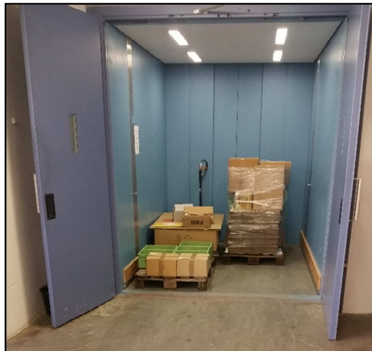
Anlage 32 Beladung Lastenaufzug PG 3
