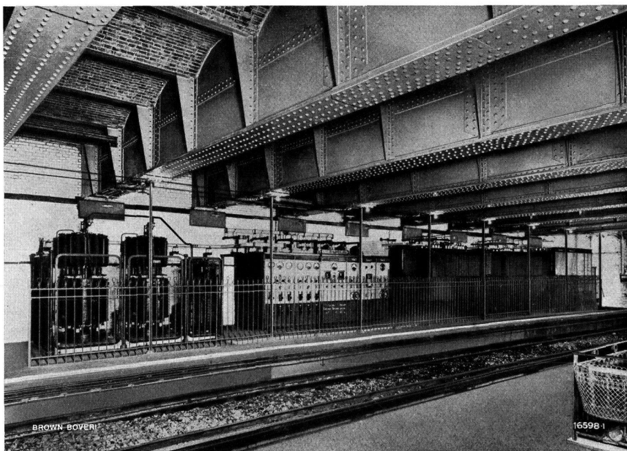
Abb. 56. — Gleichrichteranlage der Compagnie des Chemins de fer Métropolitains de Paris, Unterstation Nation. Zwei Gleichrichter Type GRZ 56, 1080 kW, 600 V.
