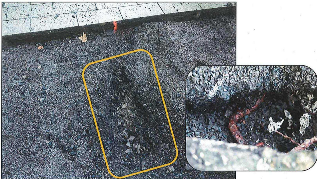
Abbildung 47 und 48 Die Versuche, mit der Kreuzhacke den Boden zu öffnen, scheiterten im Ansatz, ein Eindringen war schlichtweg unmöglich. In der Bettung der Betonplatten fanden sich vereinzelt Feinwurzeln (siehe Abbildung 48)
