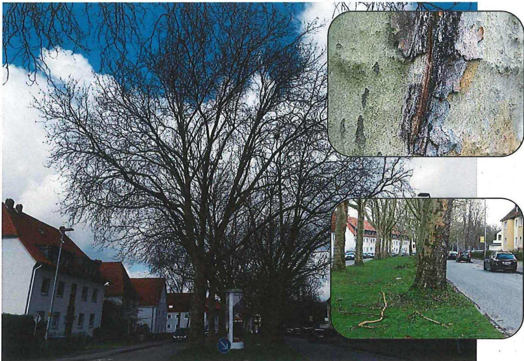
Abbildung 44, 45 und 46 Vielfach in Deutschland zu sehen - innerstädtische Platanen-Allees, meistens zwischen 50 und 70 Jahren alt. Oben rechts: Rissbildung an Stamm, Stämmlingen und Ästen – ein modernes Schadsymptom an der Baumart. Unten rechts: Astbruch als Folge der Massaria-Erkrankung.
