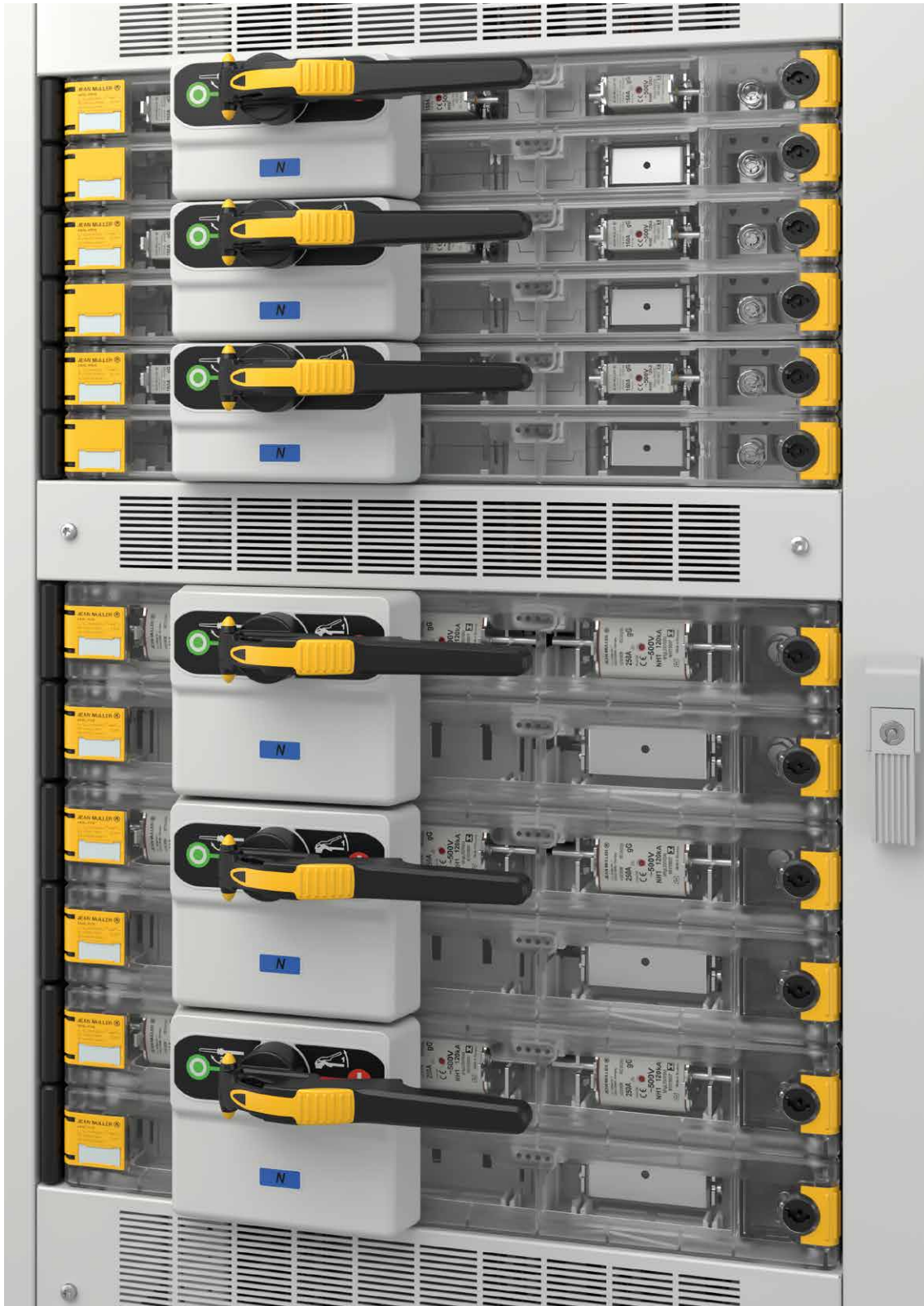
Beispiel 2: Schaltschrank/Sample 2: switchgear cabinet Lasttrennschalter mit Sicherungen – SASILplus 4-polig mit Anschluss rechts auf 185mm Sammelschienensystem Switch-disconnector-fuses – SASILplus 4-pole with cable connection compartment on right side on 185mm busbar system
