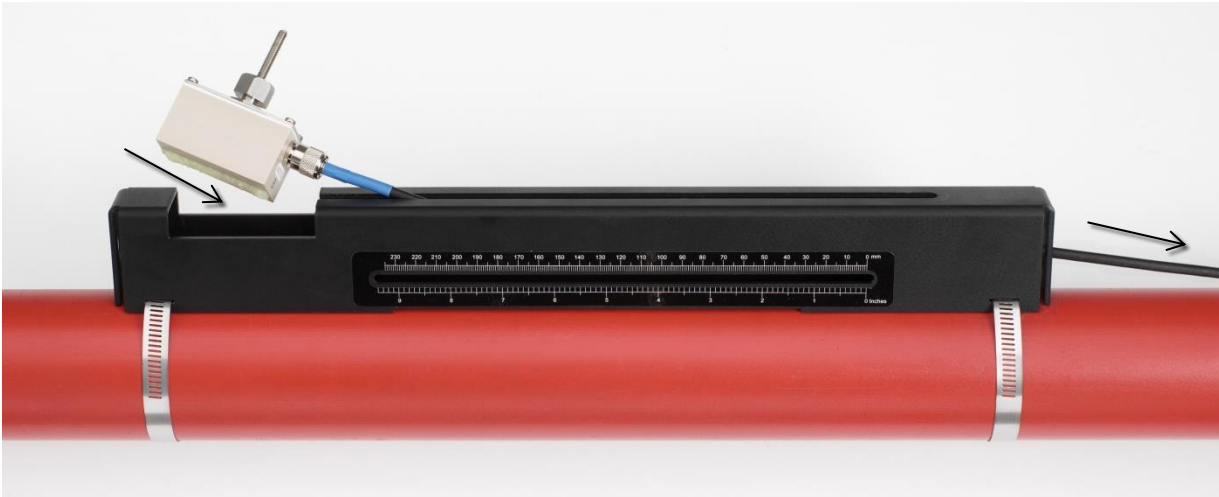
Abbildung 13 Installation des nachgelagerten Messwandlers (blau)
