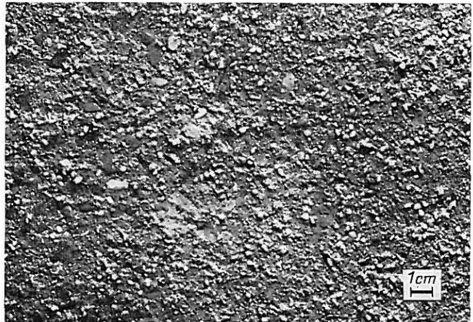
Bild 6 Junger Laborbeton ( W/Z = 0,40 und 3,5 % Luftporen, ohne Imprägnierung) nach 90 Frost-Tausalz-Wechseln (Abwitterung des Feinmörtels) [16]
