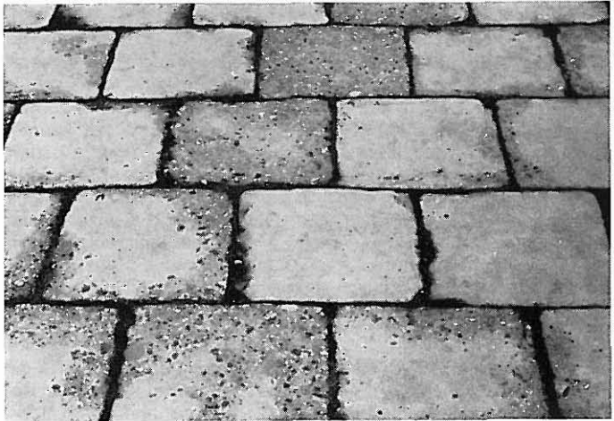
Bild 7 Eingebaute Gehwegplatten mit und ohne Tausalzschäden
