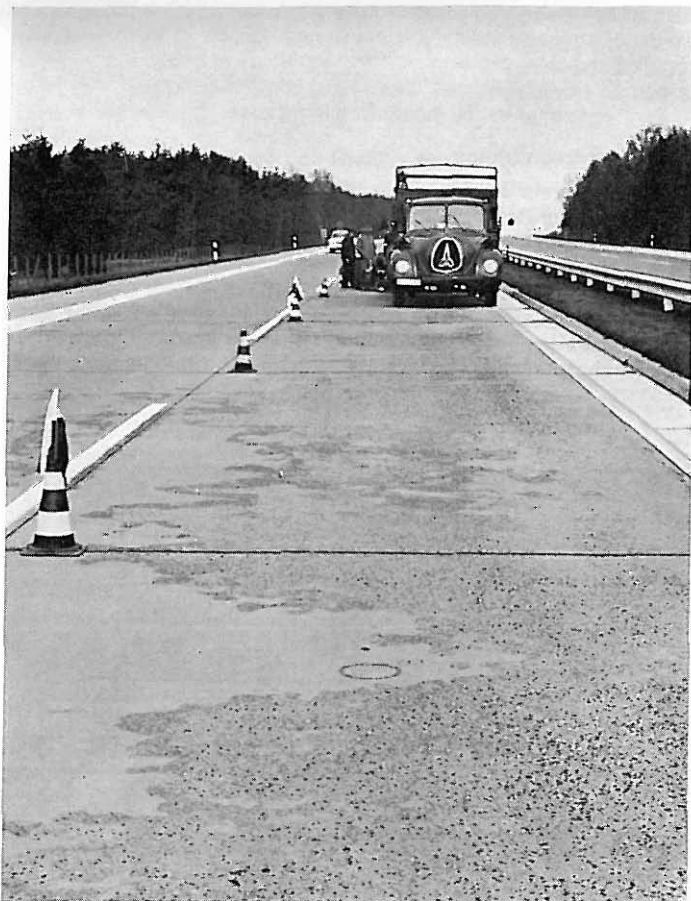
Bild 2 Betonstraße mit Tausalzschäden
